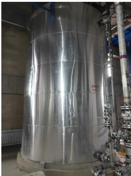
图 4-3 事故槽现场图片
